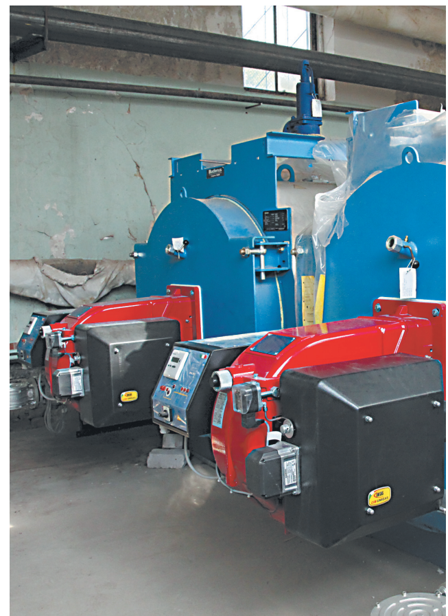
Новое оборудование позволит обеспечить надежное, качественное теплоснабжение потребителей, снизить затраты на энергоресурсы и обслуживание котельных.
