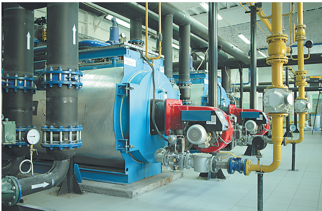
Новое оборудование позволит обеспечить надежное, качественное теплоснабжение потребителей, снизить затраты на энергоресурсы и обслуживание котельных.
