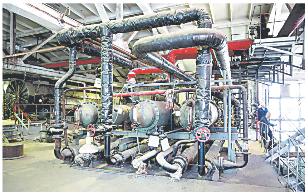
Котельная на ул. Баранова, 11. Все устаревшее оборудование будет заменено на новое, современное и экономичное.
