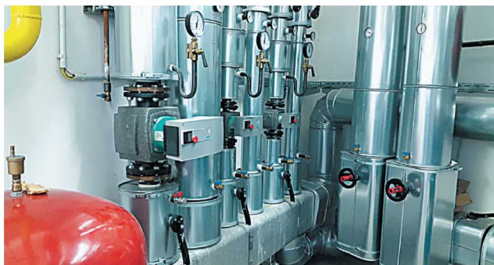
Внутренний вид котельной, отапливающей малоэтажные таунхаусы.
